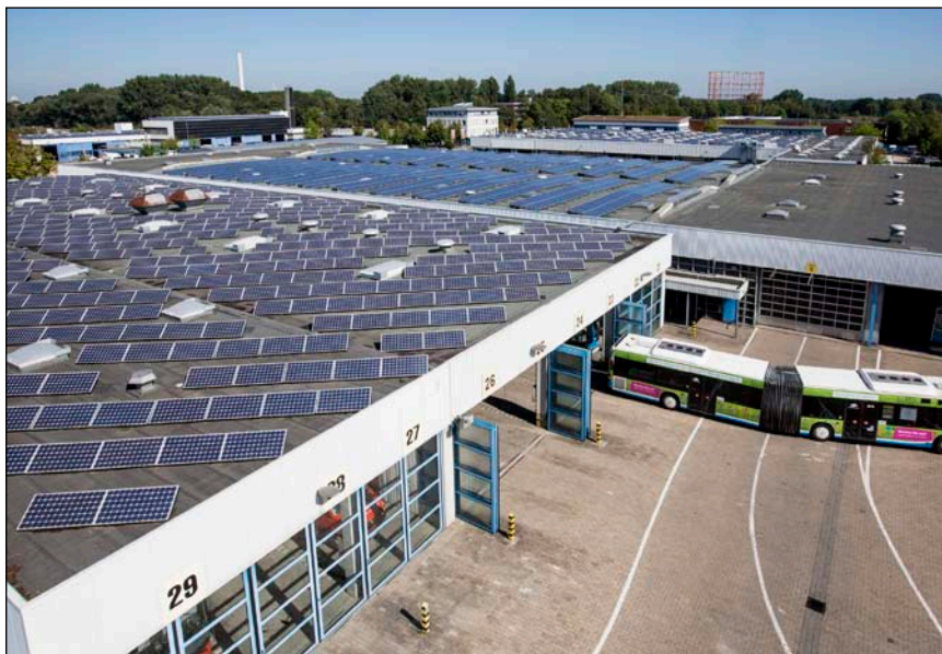
Bild 3: Photovoltaikanlagen auf dem Dach der Bushallen speisen die Ladestation am Betriebshof der Stadtwerke.
