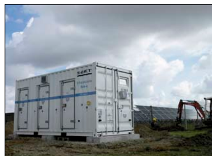
Bild 2: Batteriemodul im Container auf dem SmartRegion Gelände
