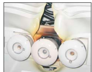
Bild 11: Dieser Sicherungseinheit ist sehr heiss geworden. Am Kontakt zur Fassung trat ein hoher Übergangswiderstand auf.
