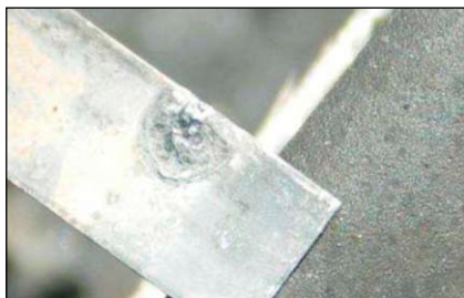
Bild 4: Rest einer mangelhaften Lötverbindung.
