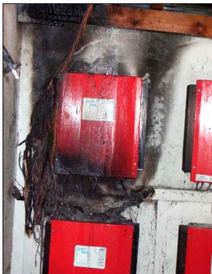
Bild 12: Verbrannte Leitungen an einem Wechselrichter.
