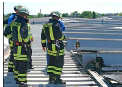
Bild 6: Brand Generatoranschlusskasten. Exponierter DC-Verteiler, Überhitzung, Schalter versagte und löste Lichtbogen aus!
