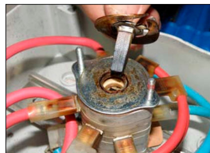
Bild 7: Ein „überlebender“ Schalter zeigt deutliche Überhitzungsspuren. Die Achse ist geschrumpft und karbonisiert.
