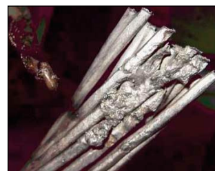
Bild 10: Das Ende einer Aluminiumleitung aus einer losen Klemmstelle zeigt Schmelzspuren.
