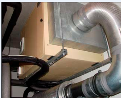
Bild 2: 25-30% der thermischen Energie wird über die Abluftwärmepumpe bereitgestellt.
