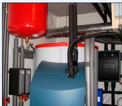
Bild 4: Erd- und Abluftwärmepumpe mit kleiner Energiezentrale.
