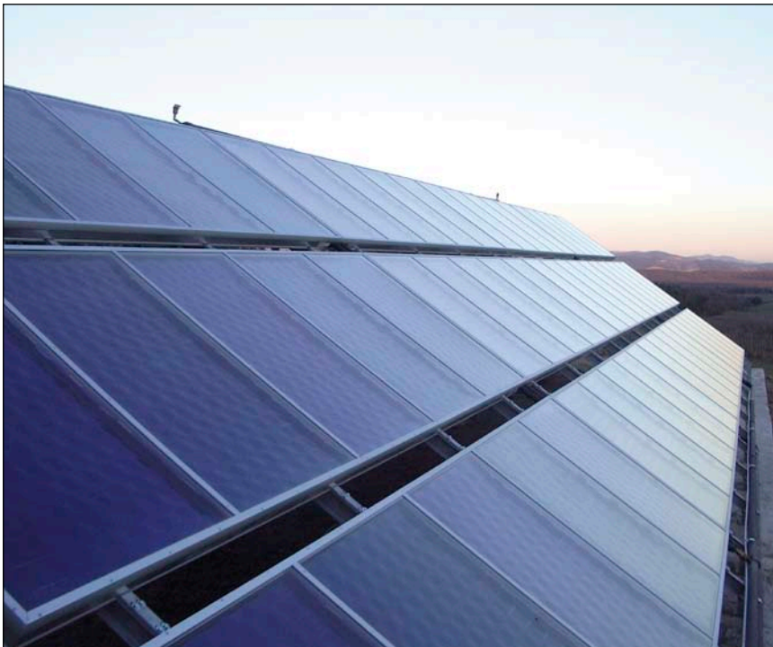
Bild 1: Aufgeständerte Solarthermie-Anlage auf einem Hotel
