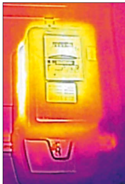
Bild 4: Stromzähler entwickelt Wärme
