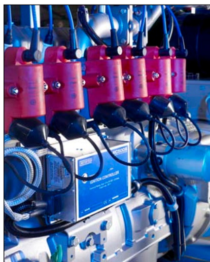
Bild 2: BHKW-Aggregat von Tuxhorn
