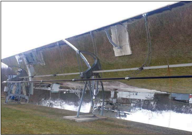
Bild 1: Parabolrinnenkollektor im Außengelände
