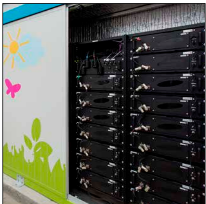
Bild 2: Batteriespeichercontainer an einer Schnellladestation für Elektrobusse bei den Stadtwerken Münster (schwarz im Vordergrund die Lithiumionen-Batterie mit Zellen der Firma Samsung SDI, nicht sichtbar direkt dahinter darin ein bidirektionaler Umrichter und die Systemsteuerung)
