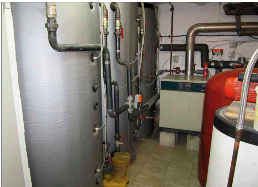
Bild 3: Wassertanks statt Batteriespeicher: Mittels großer Heizungspufferspeicher wird die Betriebszeit stromerzeugender Erdgasheizungen vom Heizwärme- und Warmwasserbedarf des Gebäudes entkoppelt. Durch diesen „funktionalen Stromspeicher“ kann ein BHKW unabhängig vom aktuellen Wärmebedarf immer dann Strom erzeugen, wenn die Sonne nicht scheint und die erzeugte Wärme für eine spätere Nutzung einlagern. Umgekehrt kann das BHKW den Betrieb einstellen, sobald die solare Stromerzeugung den Bedarf des Objektes deckt und die Wärmeversorgung erfolgt aus den geladenen Pufferspeichern.
