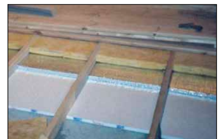
Bild 7: In dieser Abbildung ist der Aufbau der Grundfläche (auf dem das Erdmaterial ruht) zu sehen. Diese besteht (von unten nach oben) aus Betonfußboden, Styropor, Vakuum-Isolierung, Glaswolle und dann Holz.
