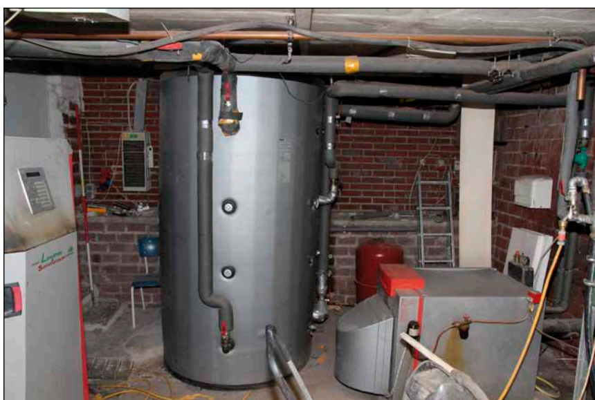
Bild 4: Blick in den abgetrennten Heizungsraum im Nebengebäude. Hier einer der Pufferspeicher (2200 l) für das warme Wasser vom Stalldach.
