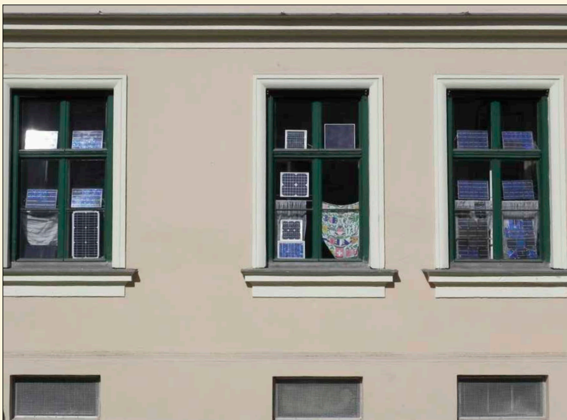
Stromerzeugende Fensterfassade in teiltransparenter Low-Tec-BIPV (Building-integrated photovoltaics) Ausführung
