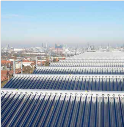
Thermische Solaranlage im Wärmenetz von Hamburg-Wilhelmsburg
