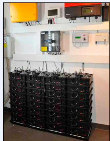
Bild 2: Aquion Batterie-Installation in Wohnhaus
