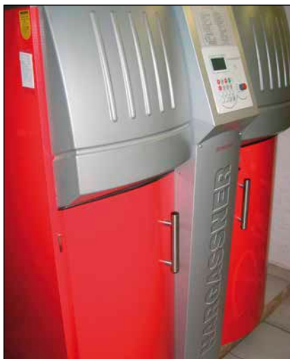
Bild 4: Holzpelletkessel zur Wärmeversorgung
