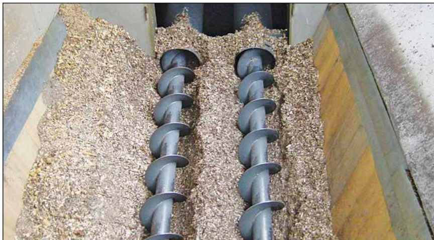
Bild 1: Hackschnitzeldosierer in einem Landwirtschaftsbetrieb. Bei der Anschaffung neuer Biomasseheiztechnik sollte darauf geachtet werden, dass entsprechend der aktuellen Preise mit verschiedenen Heizmaterialien gearbeitet werden kann.
