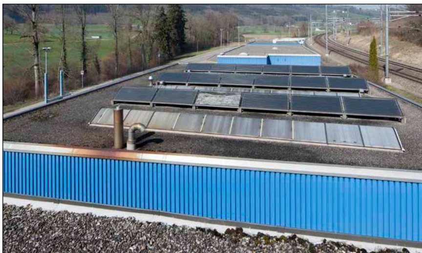
Vorher: Ein Glasbruch setzte die alte Sonnenkollektor-Anlage außer Betrieb und gab den Impuls zu einer Sanierung
