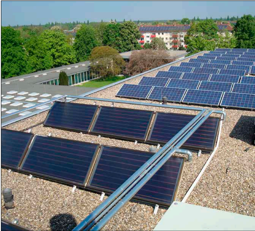
Solare Kühlung verbindet man klassischerweise mit Solarthermie. Ist jedoch Photovoltaik die bessere Lösung?
