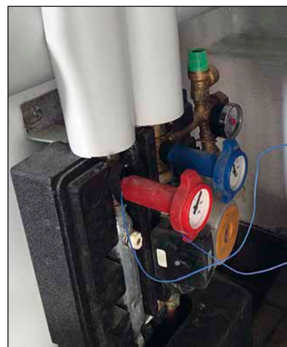
Bild 3: Die Verkleidung wird abgenommen und die Messfühler für die Temperaturmessungen an Vor- und Rücklauf angebracht. Dabei ist Vorsicht angeraten: Das Sicherheitsventil ist hier nicht mit einer Ablaufleitung verbunden, so dass heißer Dampf ungehindert in den Raum austreten kann
