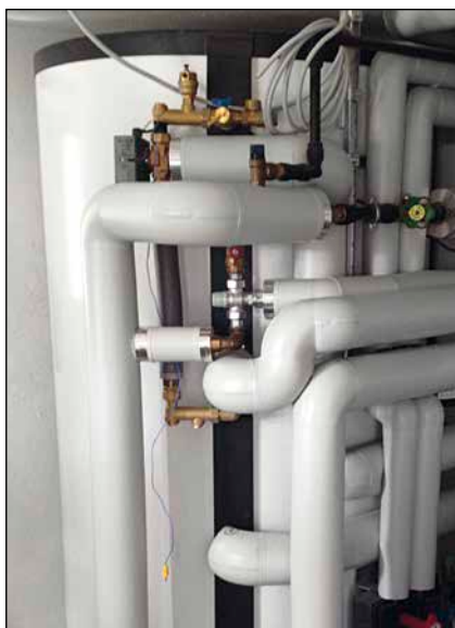
Bild 2: Ein Fall fürs Lehrbuch: perfekt gedämmte Rohrleitungen bis zum Speicher
