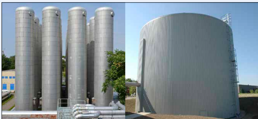
Bild 2: Heißwasserspeicher 6.480 m 3 (links), Planung 160°C, 22 bar, Integration in die Primärtrasse, Chemnitz, Fernwärme mit KWK, Betreiber inetz/eins, Warmwasserspeicher 2.000 m 3 (rechts), Ein-Zonen-Speicher, solares Nahwärmesystem Braedstrup (Dänemark), Betreiber Brædstrup Fjernvarme
