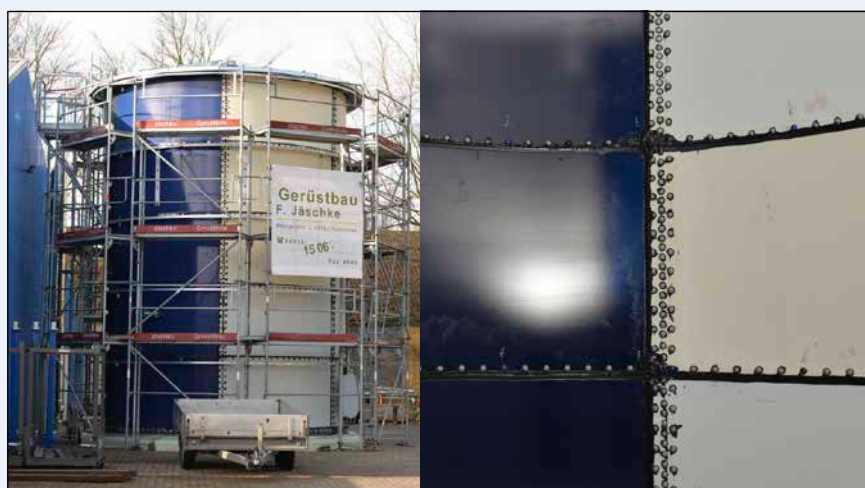
Bild 3: Pilotspeicher in Nortorf (links), ca. 100 m 3 , Ein-Zonen-Speicher, Test von unterschiedlichen Beschichtungen, Innenansicht (rechts), Stand April 2016
