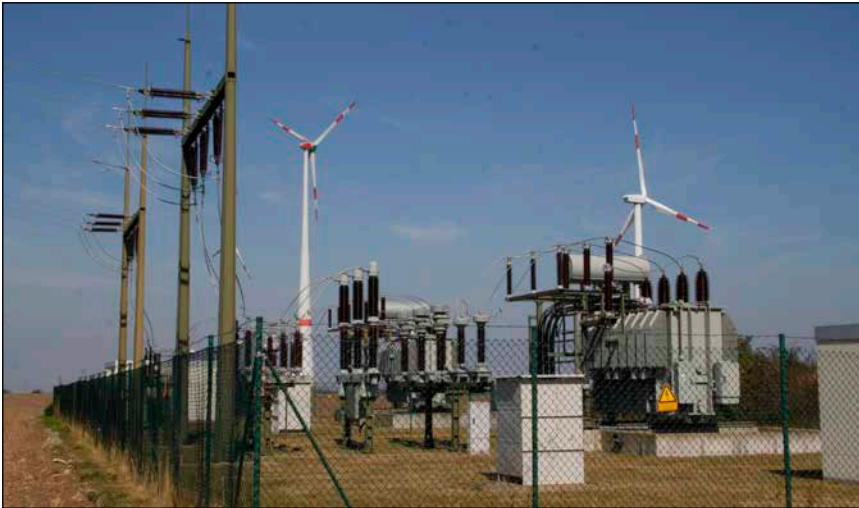
Bild 1: Ein Windpark mit seinem eigenen Umspannwerk markiert den gegenwärtigen Stand der Entwicklung: Noch immer speichern Erneuerbare als singuläre Technologien ein und verzichten auf mögliche Synergieeffekte von Verbundlösungen
