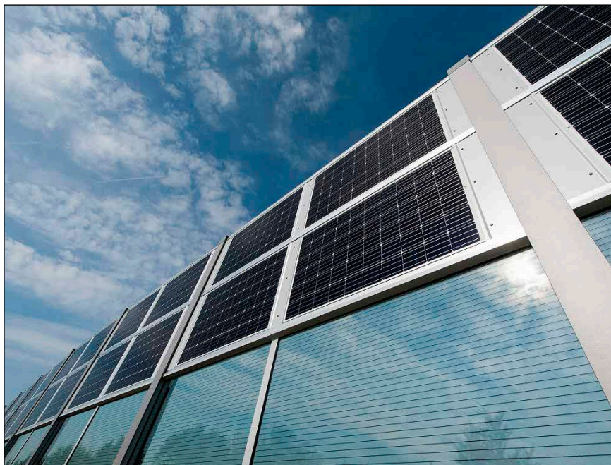
Bild 2: Blick auf die um ca 5° nach Norden geneigte Schallschutzwand mit transparentem Segment und Photovoltaikfeldern
