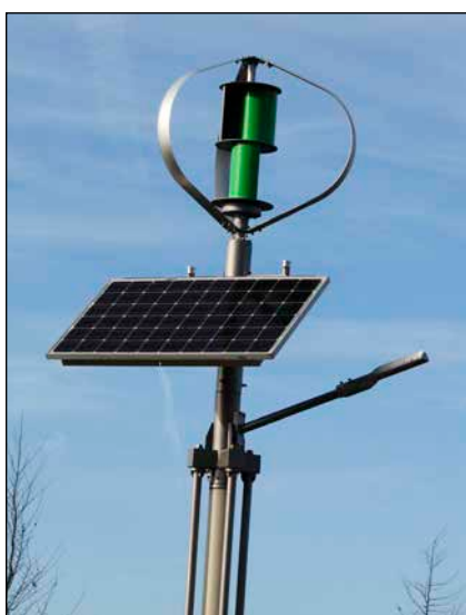
Bild 7: Innovative Photovoltaik-Windkraft-Kombinalage zur Versorgung der LED-Parkplatzleuchten
