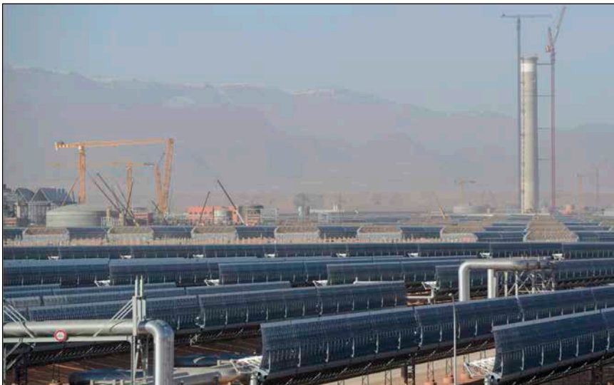
Bild 1: Der Bau der Solarkraftwerke ist Technikschauspiel. Es stellte große Aufgaben an die Logistik beim Transport der Komponenten vom Meer zum Tor der Sahara
