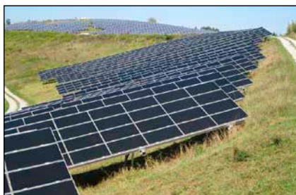
Bild 1: Ansicht eines Teils des Solarparks (Westhang)
