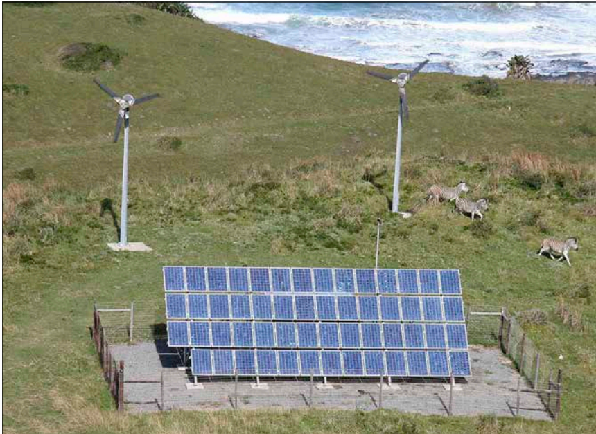
Bild 1: Autarke Energieversorgungseinheit bestehend aus PV- und Windgeneratoren in Verbindung mit einem Batteriespeicher
