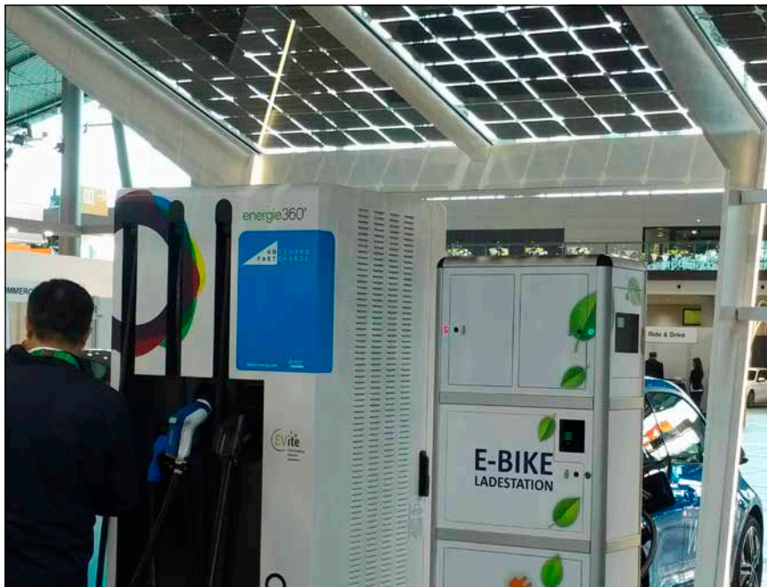
Bild 1: Auch Ladesäulen (links für Elektroauto, rechts für E-Bike) können mit PV und Batteriespeichern kombiniert werden.
