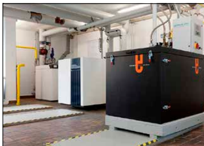
Bild 1: BHKW in Berlin-Köpenick Lindenhof
