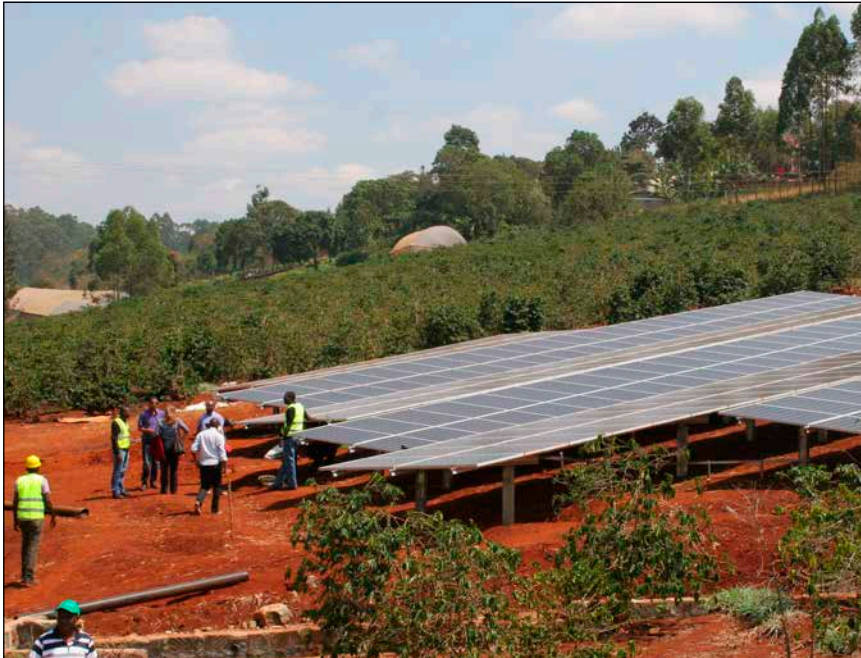
Bild 1: 66 kWp Freiflächen-Solaranlage von Ariya Leasing zur Versorgung von Wasserpumpen einer Blumenfarm in Kenia. Finanziert über ecoligo.investments innerhalb von 6 Tagen
