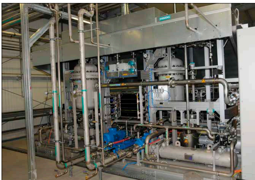
Bild 3: Der Energiepark Mainz enthält drei PEM-Elektrolyseure von Siemens, Typ Silyzer 200, die selbst mit extrem schnellen Lastwechseln umgehen und Wasserstoff bis zu 35 bar erzeugen können.
