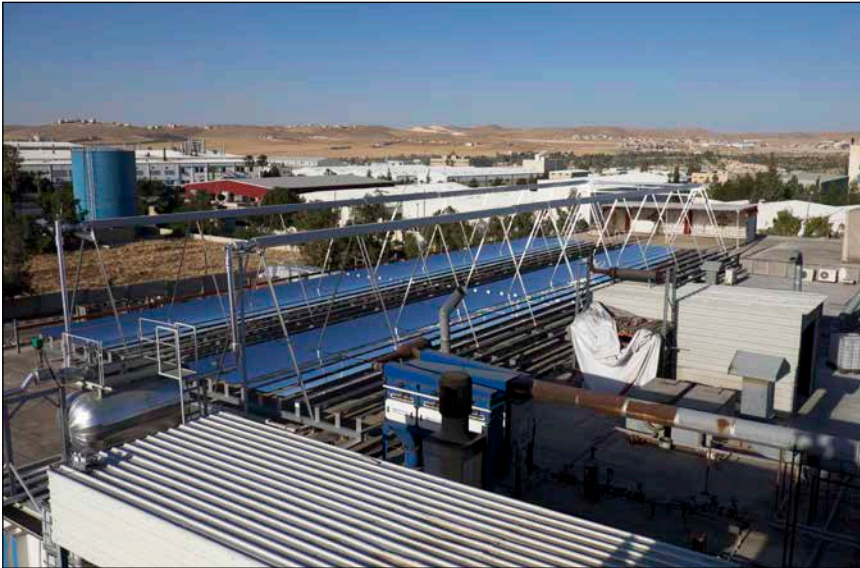
Bild 1: Mit den Fresnel-Kollektoren von Industrial Solar erzeugt RAM Pharma in Jordanien Direktampf, der im Prozess zum Sterilisieren sowie zum Trocknen oder Befeuchten verwendet wird.
