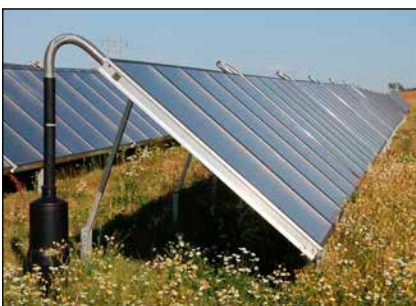
Bild 2: Flachkollektoranlage in Freilandaufstellung
