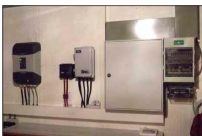
Bild 6: v.l. Sinuswechselrichter, 2 Laderegler und PV-Schalterschrank nach der Erneuerung
