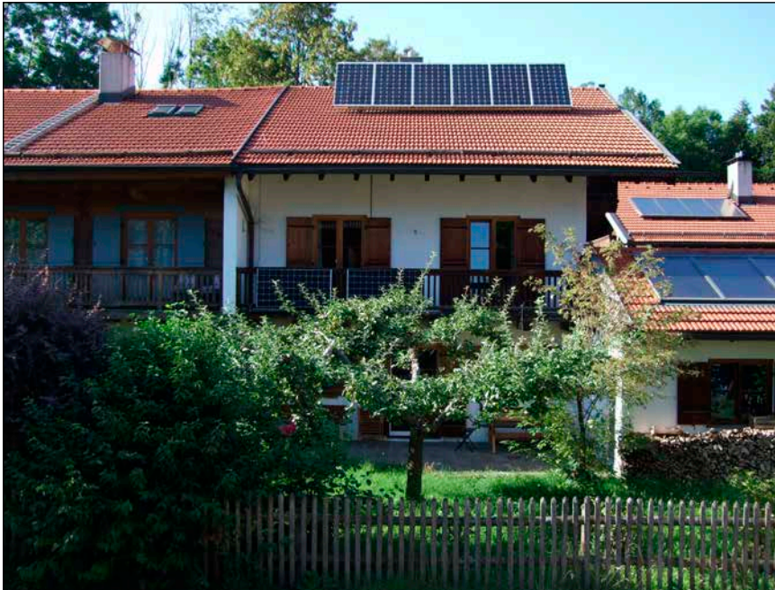
Bild 1: Im Jahr 2011 erneuerte PV-Anlage mit zwei zusätzlichen Modulen am südlichen Balkongeländer
