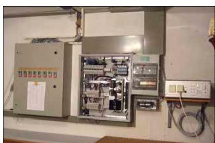
Bild 5: v.l. Heizungsregelung mit Palm-top-PC, PV-Schalterschrank mit Laderegler und Trapezwechselrichter
