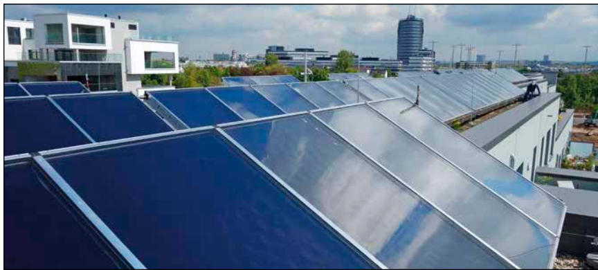
Bild 2: Kollektorfeld der SWD.SOL-Pilotanlage in Düsseldorf
