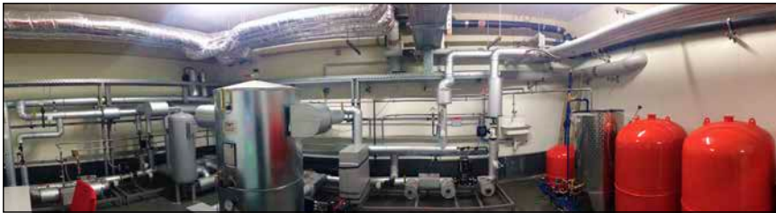
Bild 1: Einspeisestation der SWD.SOL-Pilotanlage in Düsseldorf
