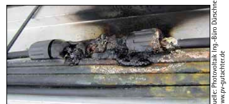
Bild 6: Abgebrannte Steckverbinder-Verbindung (Kreuzverbund)
