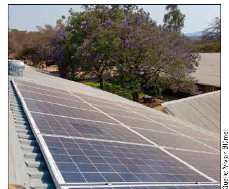
Bild 2: Teilgenerator auf dem Ostdach: Zwei Drittel der PV-Module sind nach Osten ausgerichtet, ein Drittel nach Westen.
