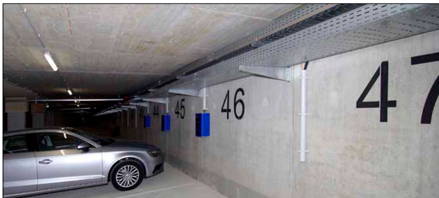
Bild 2: Alle Tiefgaragenstellplätze sind für E-Ladestationen vorgerüstet, an 25 % aller Plätze ist bereits eine Wallbox installiert (wie hier zu sehen).
