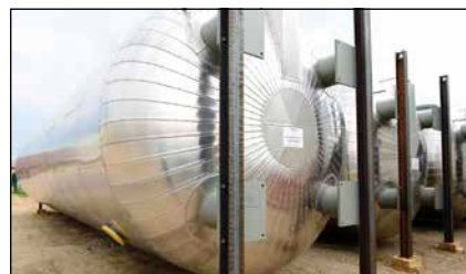
Bild 5: Neue Wärmespeicher der Stadtwerke Grevesmühlen für die städtische Nahwärmeversorgung
