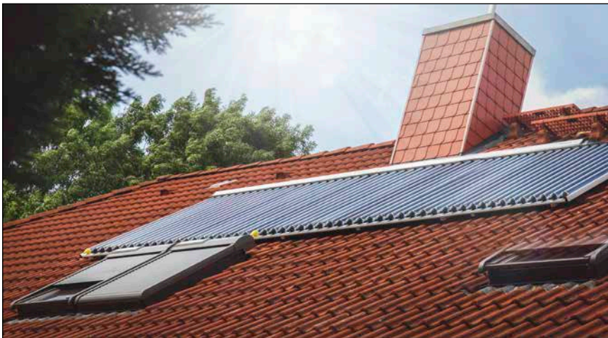
Bild 1: Solarthermieanlage zur Trinkwassererwärmung und Heizungsunterstützung
