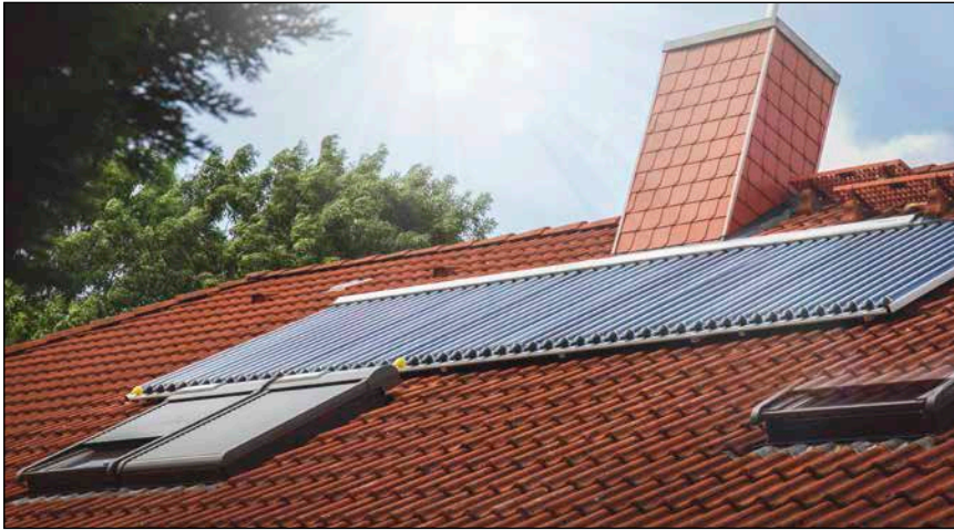
Bild 1: Solarthermieanlage zur Trinkwassererwärmung und Heizungsunterstützung
