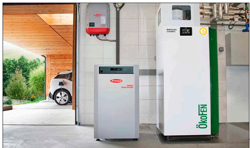
Bild 2: Das „myEnergy365“-System zur unabhängigen und ökologischen Strom- und Wärmeerzeugung im Eigenheim besteht aus einer Strom produzierenden Pelletsheizung, einer Batterie, einem Wechselrichter und einer Photovoltaikanlage.
