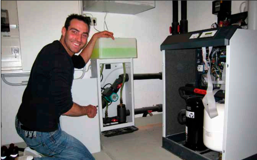
Service bei einer Erdsonden-Wärmepumpe mit einer Jahresarbeitszahl von über 4 - auch in der Praxis!
