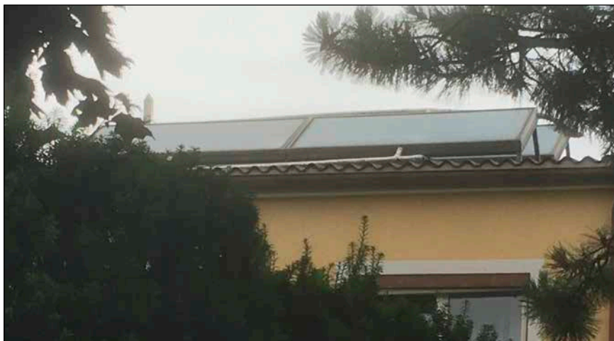
Bild 2: Die 40 Jahre alte solare Solarthermie-Anlage in Maria Enzersdorf (Österreich) wurde mit dem Preis für die älteste Anlage im Wettbewerb ausgezeichnet.
