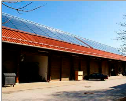
Bild 3: Freising – 300 m 2 auf Dach montierte Solarluftkollektoren
