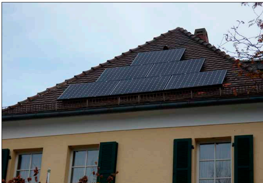
Bild 1: PV-Hausanlage in Ettlingen bei Karlsruhe.
