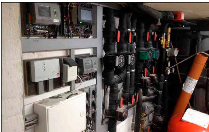
Bild 4: Technikraum mit Steuergeräten und Heizungsverteilung
