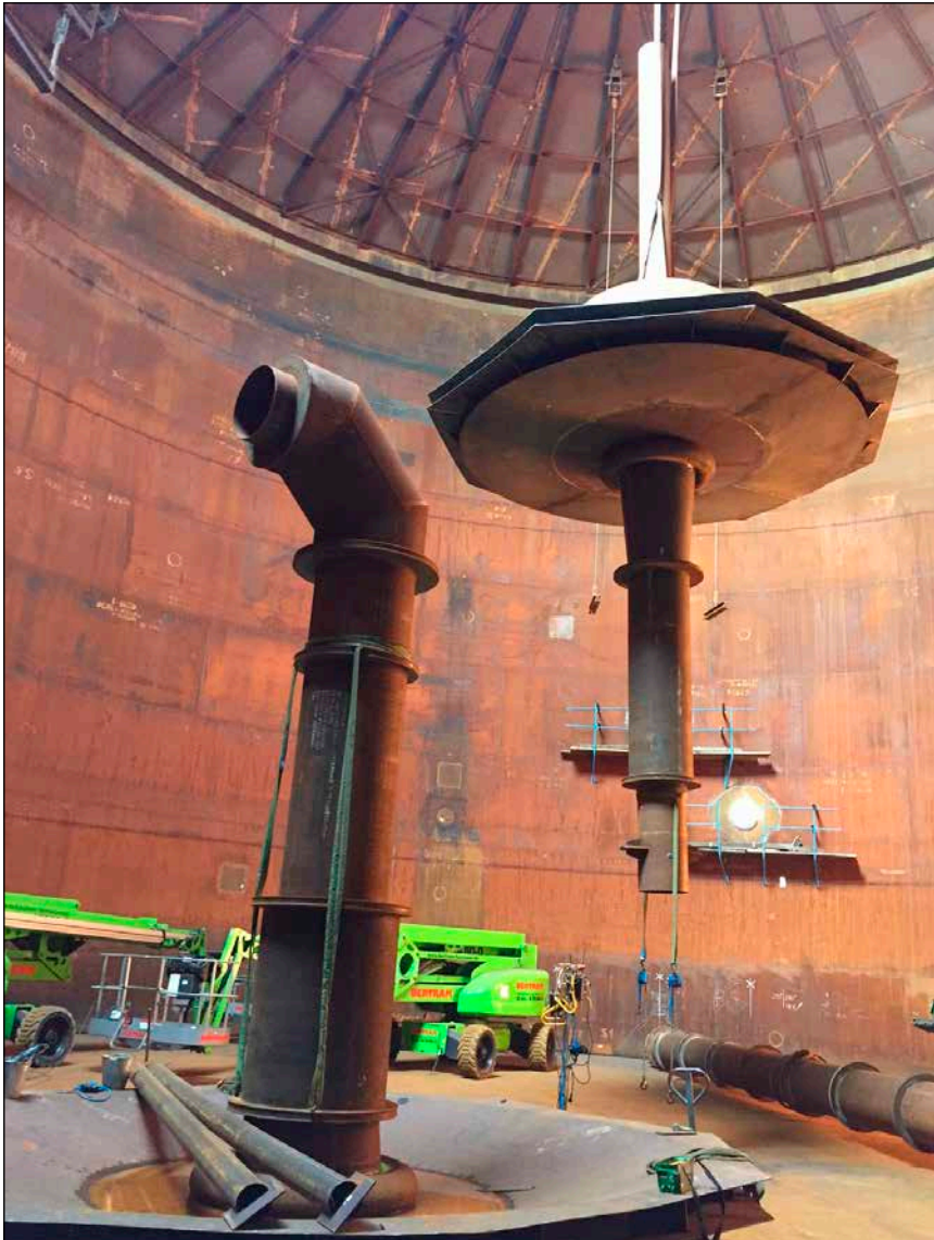
Bild 1: Um seine KWK-Anlagen flexibel laufen lassen zu können, hat Enercity einen alten Öltank zum Fernwärmespeicher umgebaut.
