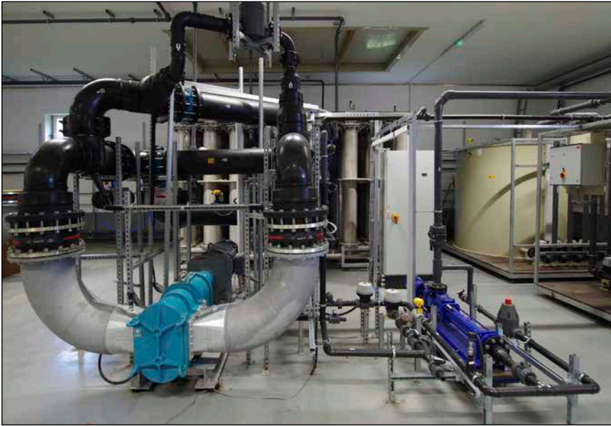
Bild 1: Blick in die Anlage: Ein Ex-Schweinstall voll Technik
