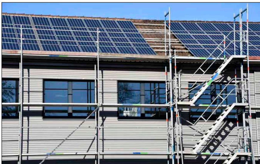
Bild 2: Vor allem für gewerbliche PV-Anlagen über 300 kWp muss die Umsetzung neu optimiert werden.
